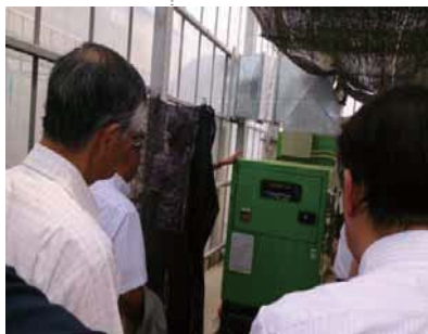
新潟県村上市、バイオガス発電機
