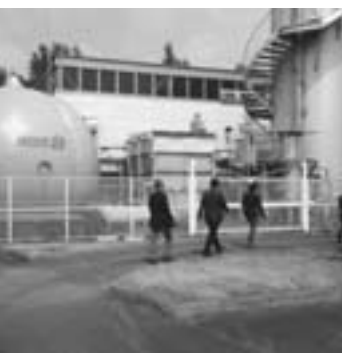
バイオガスプラント (宮城県白石市)
