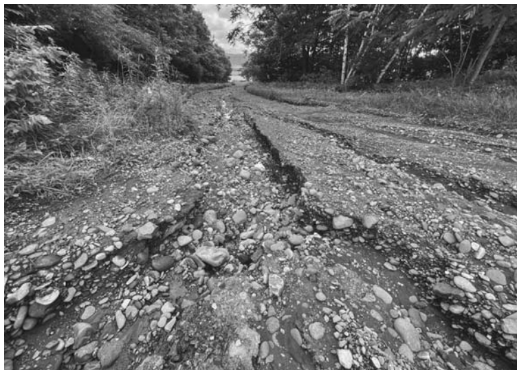
大雨で通行不能となった町道
