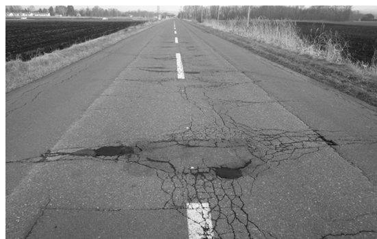
補修痕が目立つ町道
