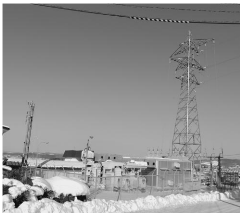
緑町の変電所
