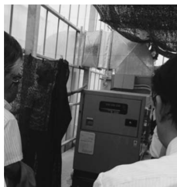
バイオガス発電機(新潟県村上市)
