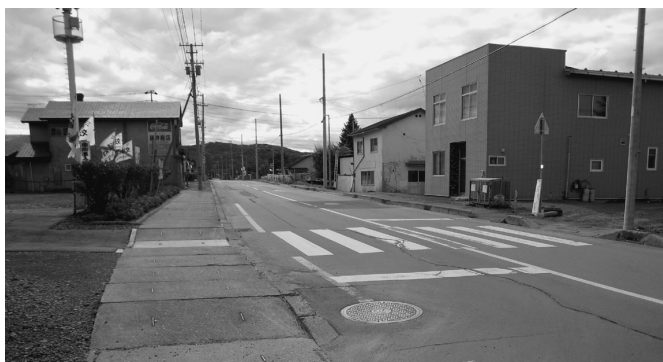
傷みがひどい町道柏木1号通り
