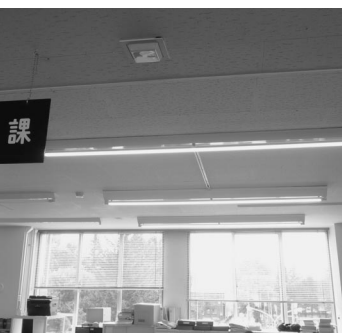
庁舎内のLED照明
