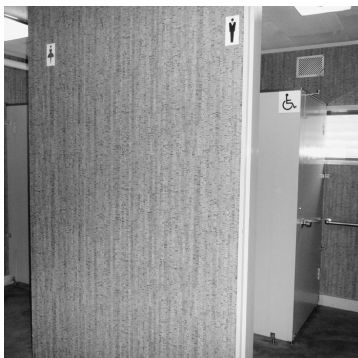
改修を待つ休憩所トイレ
